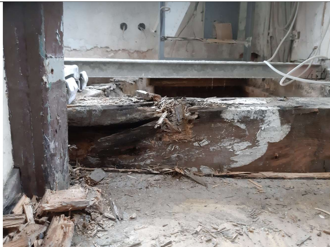
Der Grund sind massive Schäden am Holz durch den jahrelangen Wassereintritt. (AT)
